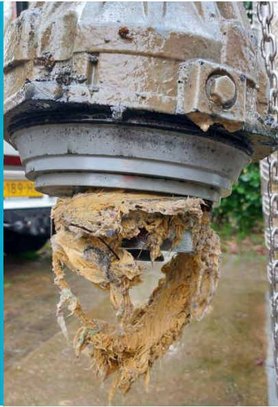
FIGUUR 3-7: DOEKJES VASTGEDRAAI IN DE WAAIER VAN EEN POMP (BRON: WDD)
