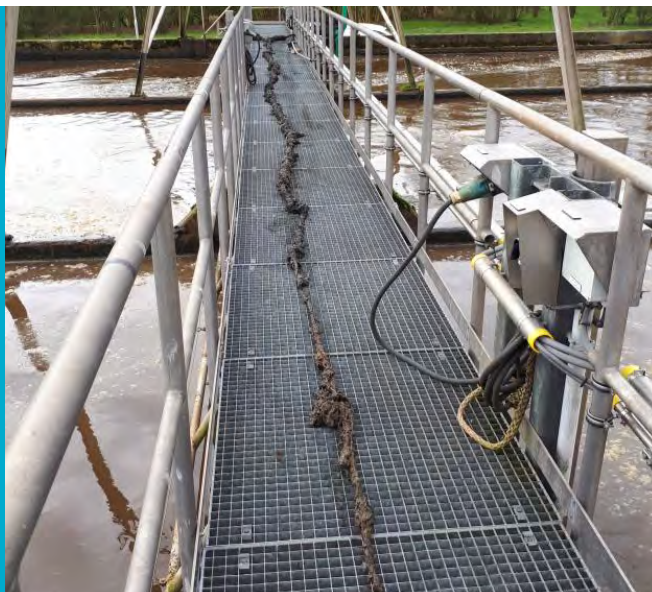
FIGUUR 3-4 EEN 'TOUW' VERWIJDERD UIT DE VOORTSTUWER, RWZI KAATSHEUVEL (BRON: WSD)
