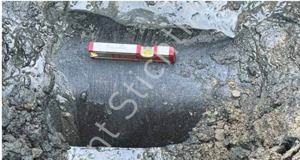
Figuur 5.11 Inmeten zakking leiding naast gemaal
