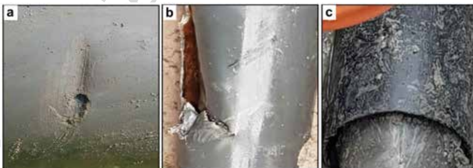
Figuur 3.6 In-situ beelden na ontgraving van buizen A-3 (a) en B-2 (b) met breuk door inslag van buitenaf, en buis B-3 (c) met scheur door slechte installatiekwaliteit.
